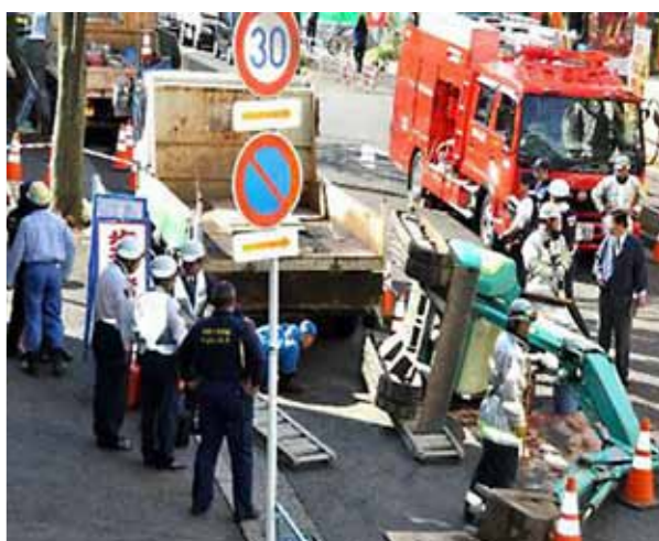
重機をトラックから降ろすときの事故も意外にある。写真は、掘削用機械(ドラグショベル)を4トン積みダンプ荷台に掛け渡した道板(アルミ製)上を走行させ道路面に降ろしていた際、道板が外れドラグショベルが転落した。スロープ状(約30度)に掛け渡した道板は固定されていなかった。(写真提供：片寄茂夫)
